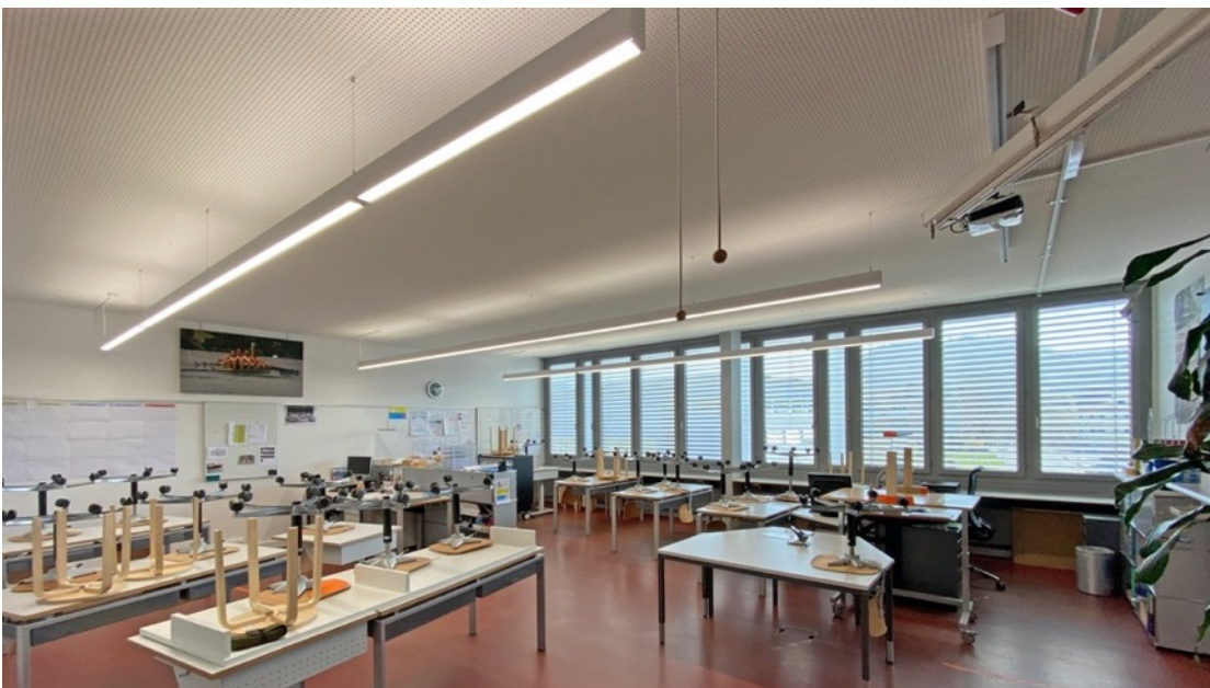
Abbildung 28: Neue Beleuchtung im Klassenzimmer Schulhaus Sennweid, Baar
