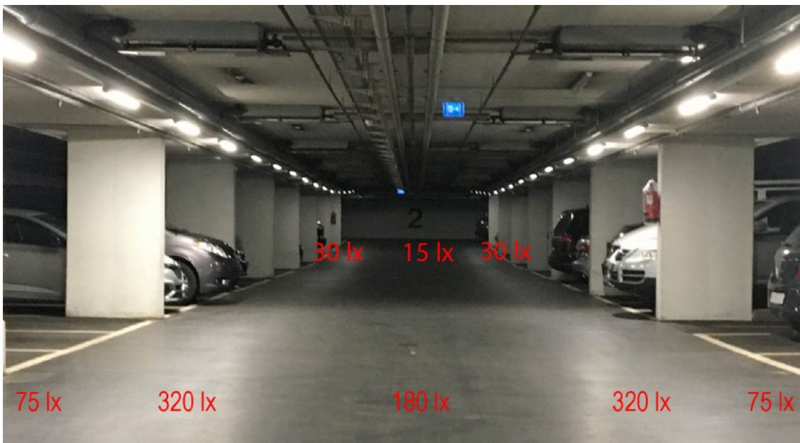
Abbildung 33: Neue Beleuchtung in der Garage Heuried (mit Beleuchtungsstärke, hinten Orientierungslicht)
