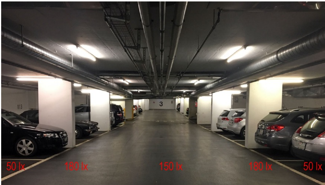
Abbildung 32: Alte Beleuchtung in der Garage Heuried (mit Beleuchtungsstärke)
