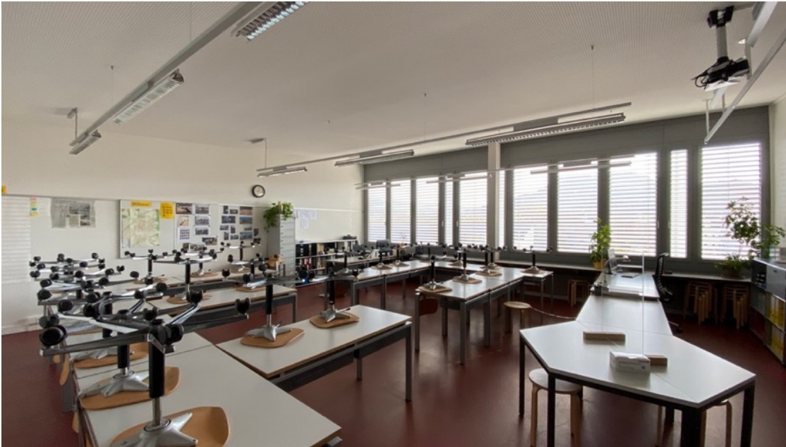
Abbildung 27: Alte Beleuchtung im Klassenzimmer Schulhaus Sennweid, Baar
