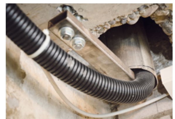
L'ancien conduit de cheminée sert aujourd'hui au passage des câbles pour l'installation solaire.
