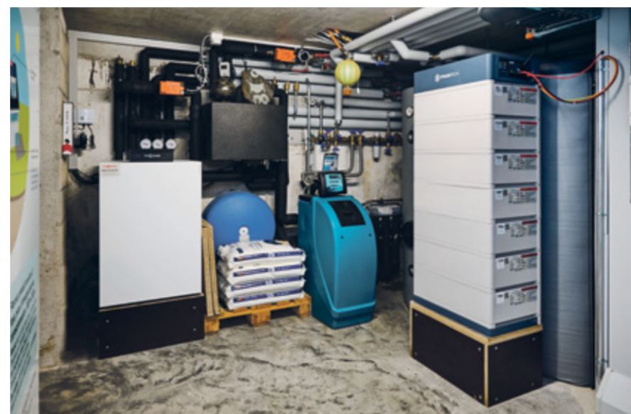
Le local technique est au sous-sol, où sont installés la pompe à chaleur et l'accumulateur d'électricité et de chaleur.
