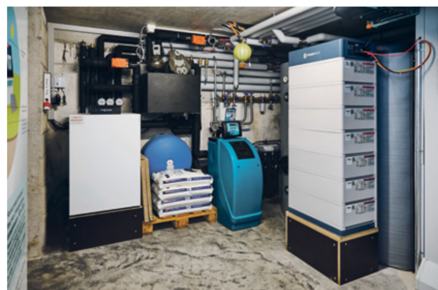
Der Technikraum im Untergeschoss, wo Wärmepumpe, Strom- und Wärmespeicher installiert sind.
