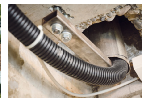
Durch den alten Kamin erfolgt heute die Kabelführung der Solaranlage.
