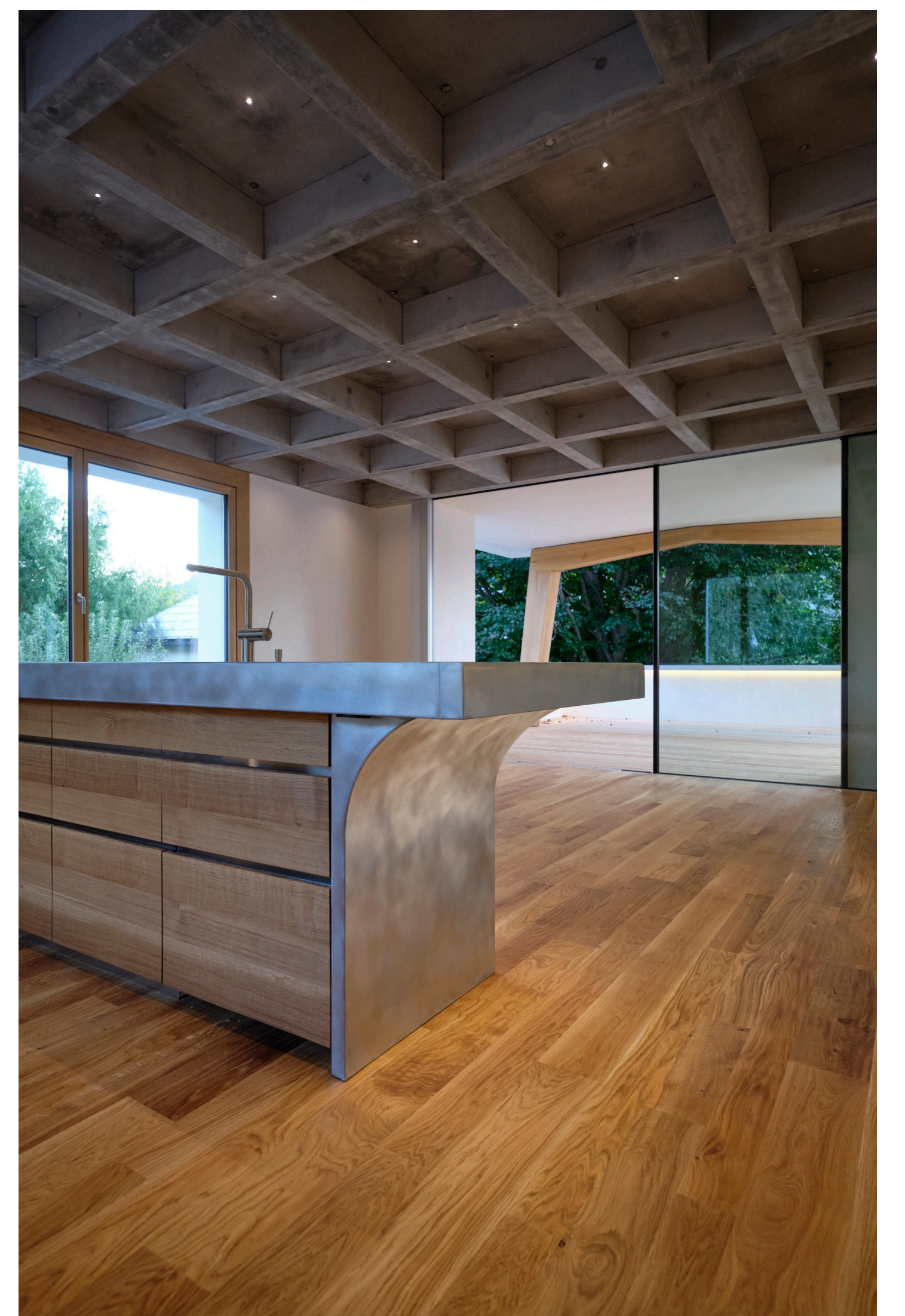
Integrierte Downlights Dot 28 in Kassettendecke
